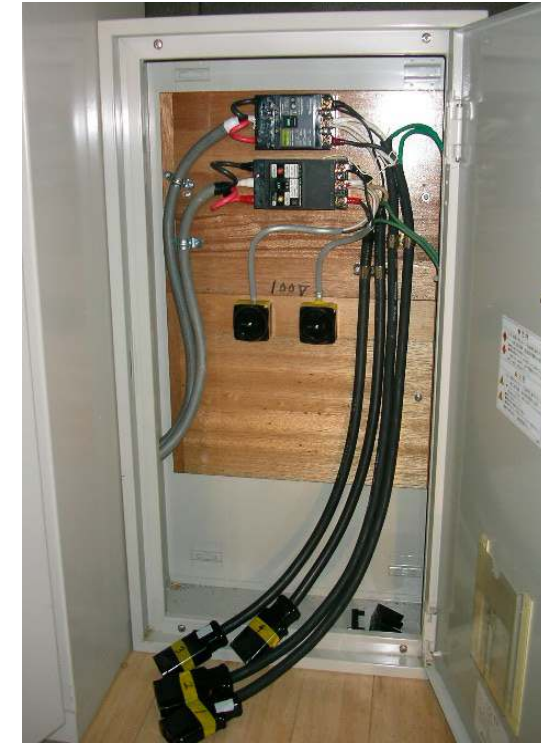
下手 仮設電源
